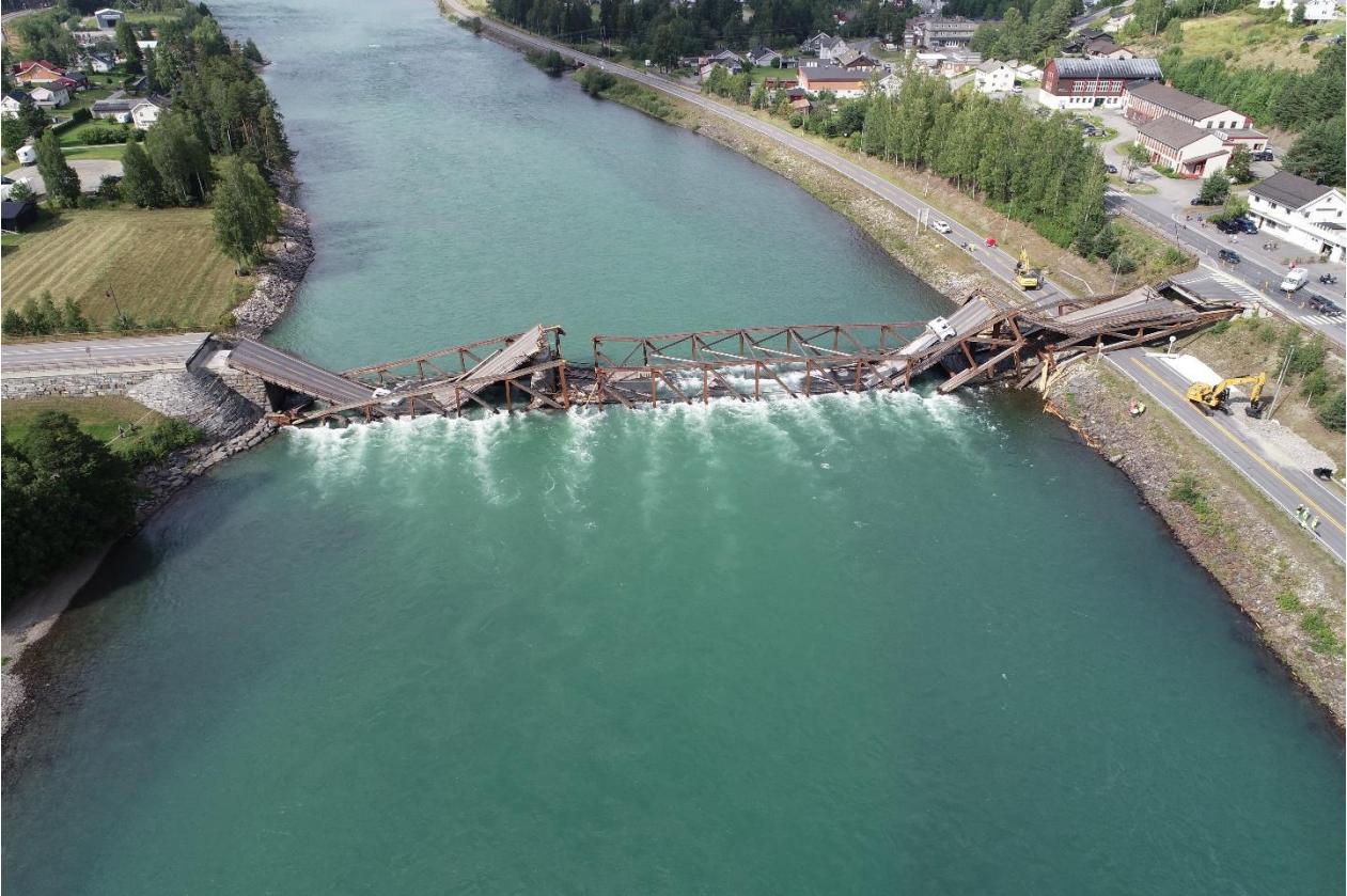
Tretten bru med to kjøretøy på brua etter kollapsen, sett fra sør. Foto: SHK
