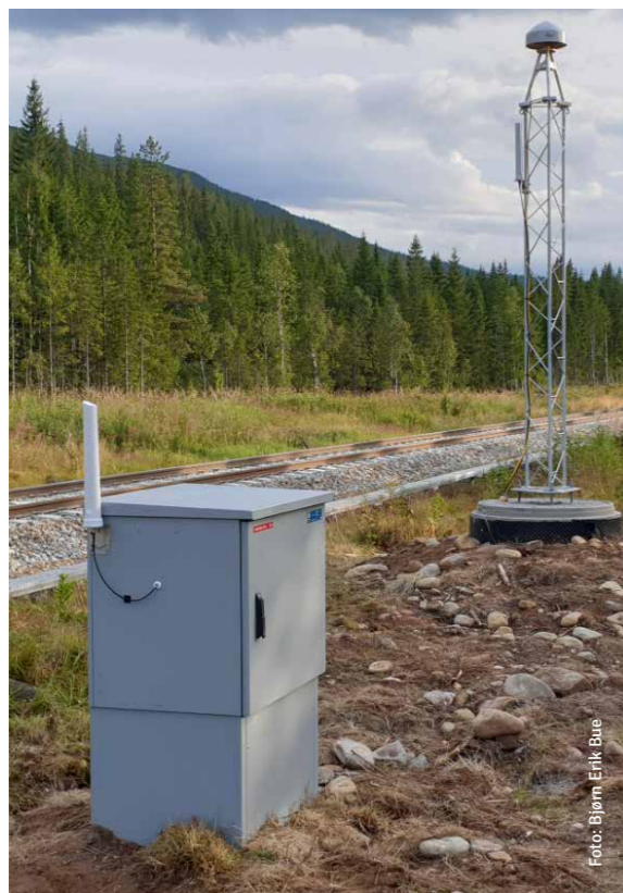
Nytablert PGS stasjon Lindmoen på Nordlands- banen.
