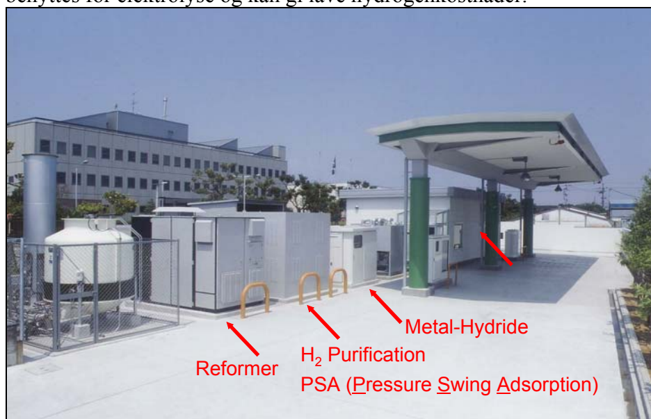
Figur 5.5. Hydrogenfyllstasjon med naturgassreformer i Osaka, Japan.
