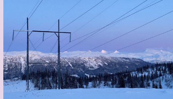
Foto: Statnett SF
