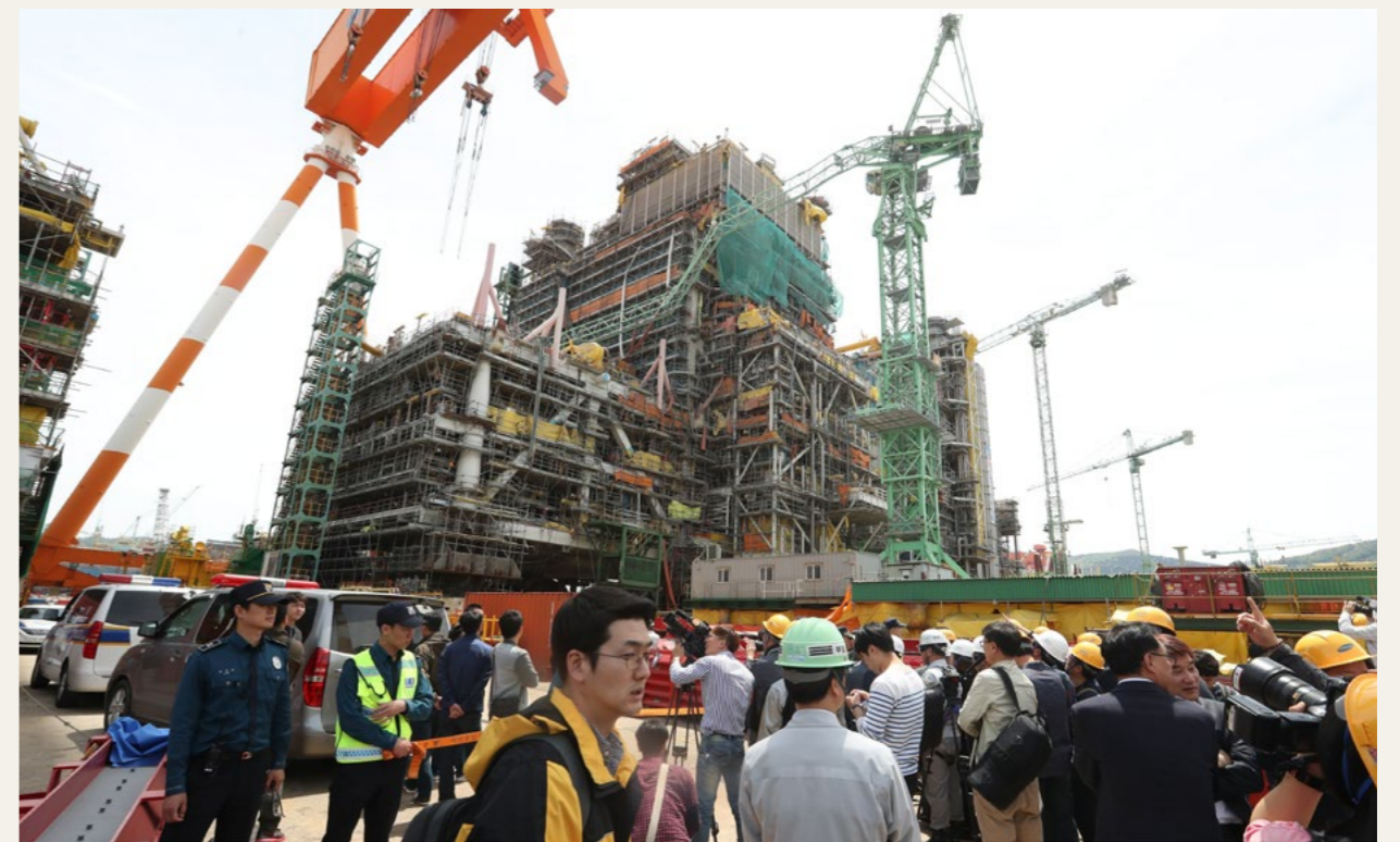
Ulykke ble klagesak: Den kollapsede kranen ved skipsverftet Samsung Heavy Industries i Sør-Korea, fotografert dagen etter ulykken 1. mai 2017. (Foto: Kim Dong-Min / Yonhap / Epa / NTB)
