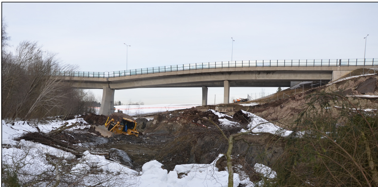
Figur 6.3 Bru på E18 over Mofjellbekken i Holmestrand kommune vart øydelagd av kvikkleireskred utløyst av terrenginngrep i 2015.
