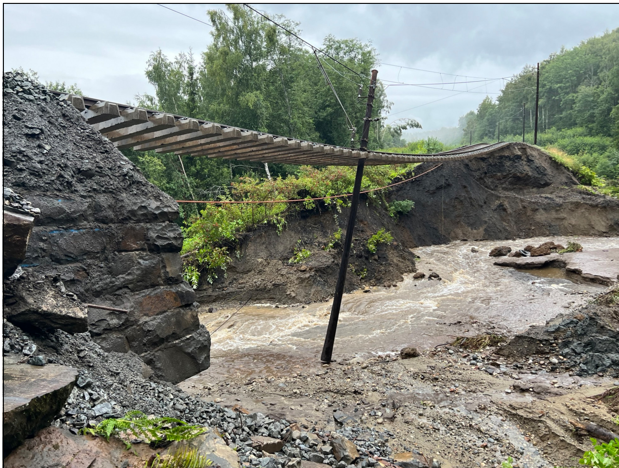
Figur 12.3 Mellom Roa og Hønefoss vart massane under jernbanesporet skylde vekk under ekstremvêret Hans i august 2023.
