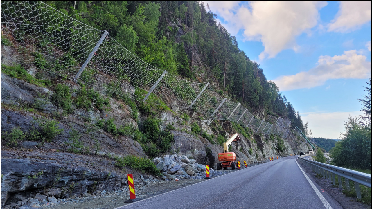
Figur 12.2 Langs E6 ved Langnesberga i Snåsa kommune er det montert fanggjerde etter fleire skredhendingar og nedfall frå bergskjæringane.
