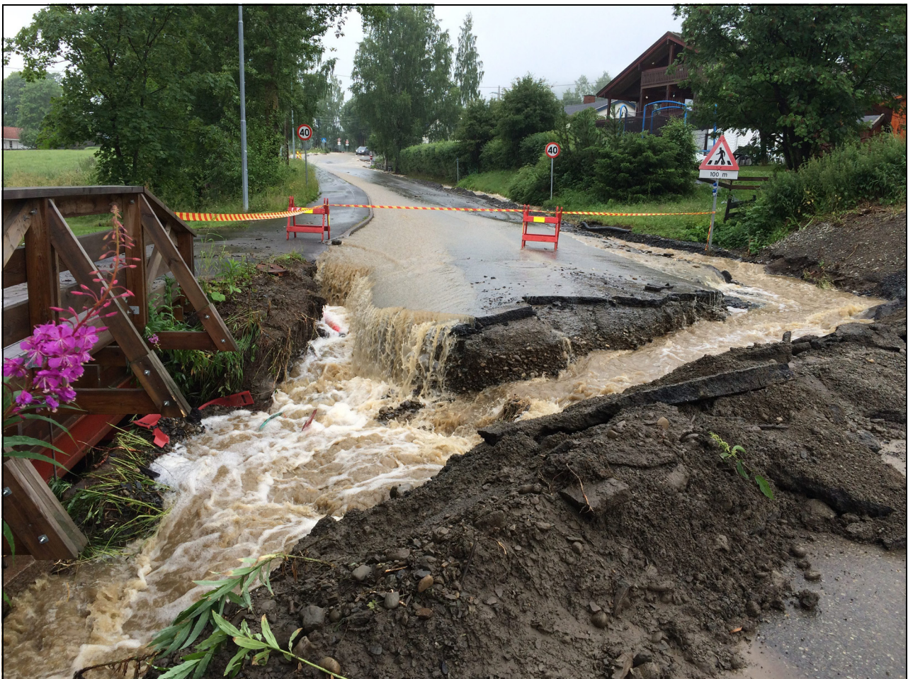
Figur 9.2 Øydelagt veg i Lillehammer kommune under ein flaumhending i juli 2014.
