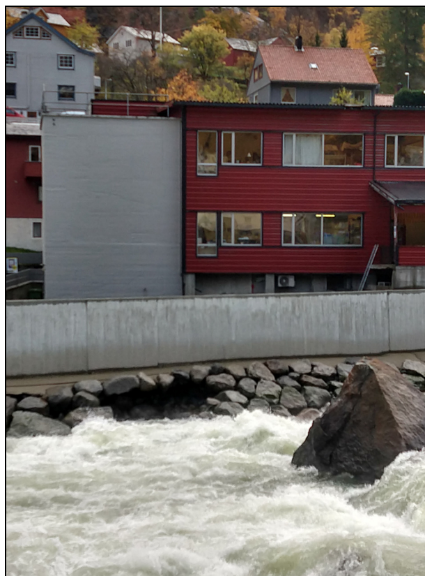
Figur 7.10 Skade på sikringstiltak i Opo i Ullensvang kommune frå oktober 2018.
