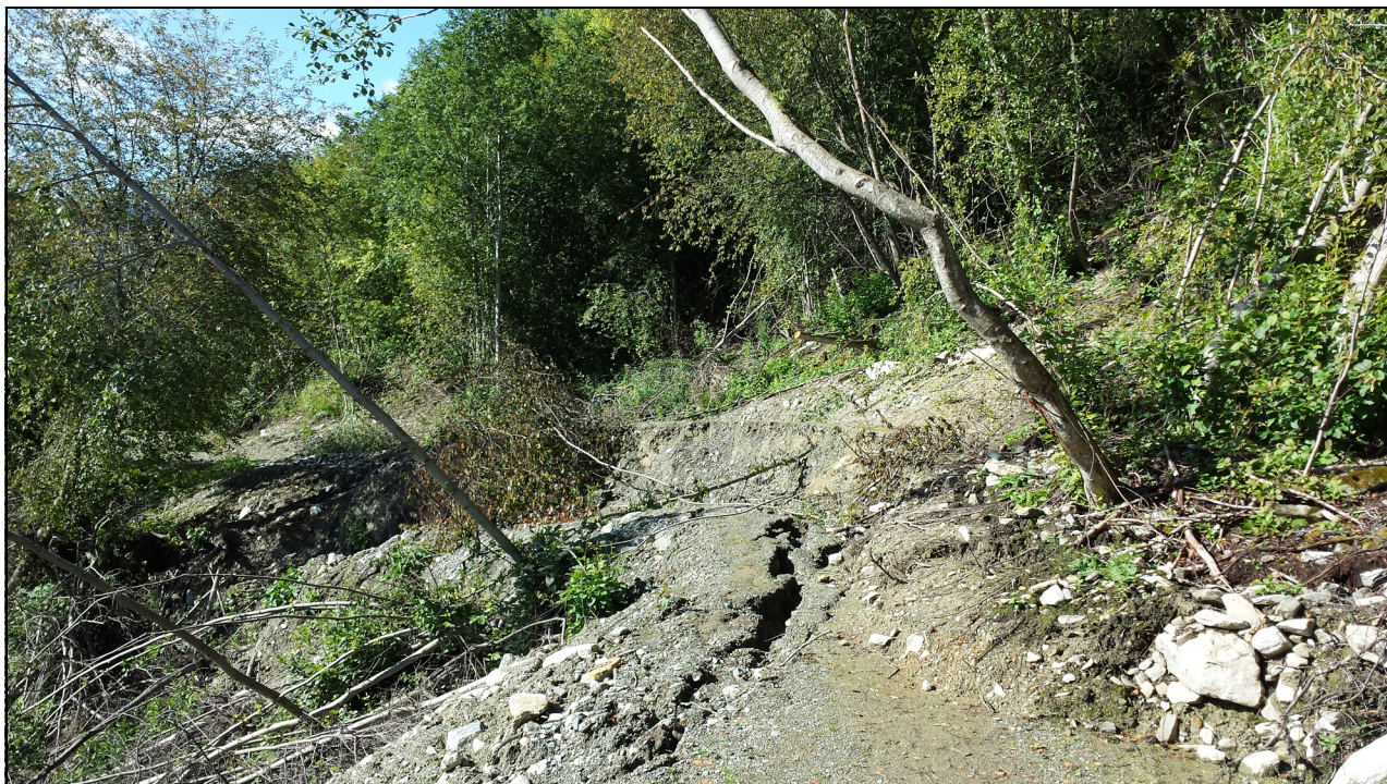
Figur 13.2 Eldre gardsveg med utgliding ved Kårfald i Gausdal kommune.
