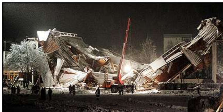
MANGE SAVNET: Redningsmannskapene jobbet i natt desperat for å finne de savnede etter at ishallen kollapset mandag. Foto: AP
