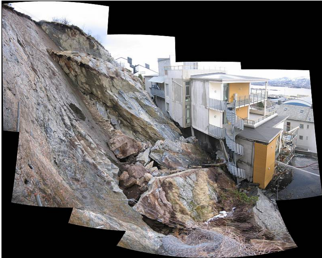
Figur 5.2 Bilde av skredområdet Bildet viser at skredet har fulgt eit bratt og relativt glatt forkastingsplan i bakkant.
