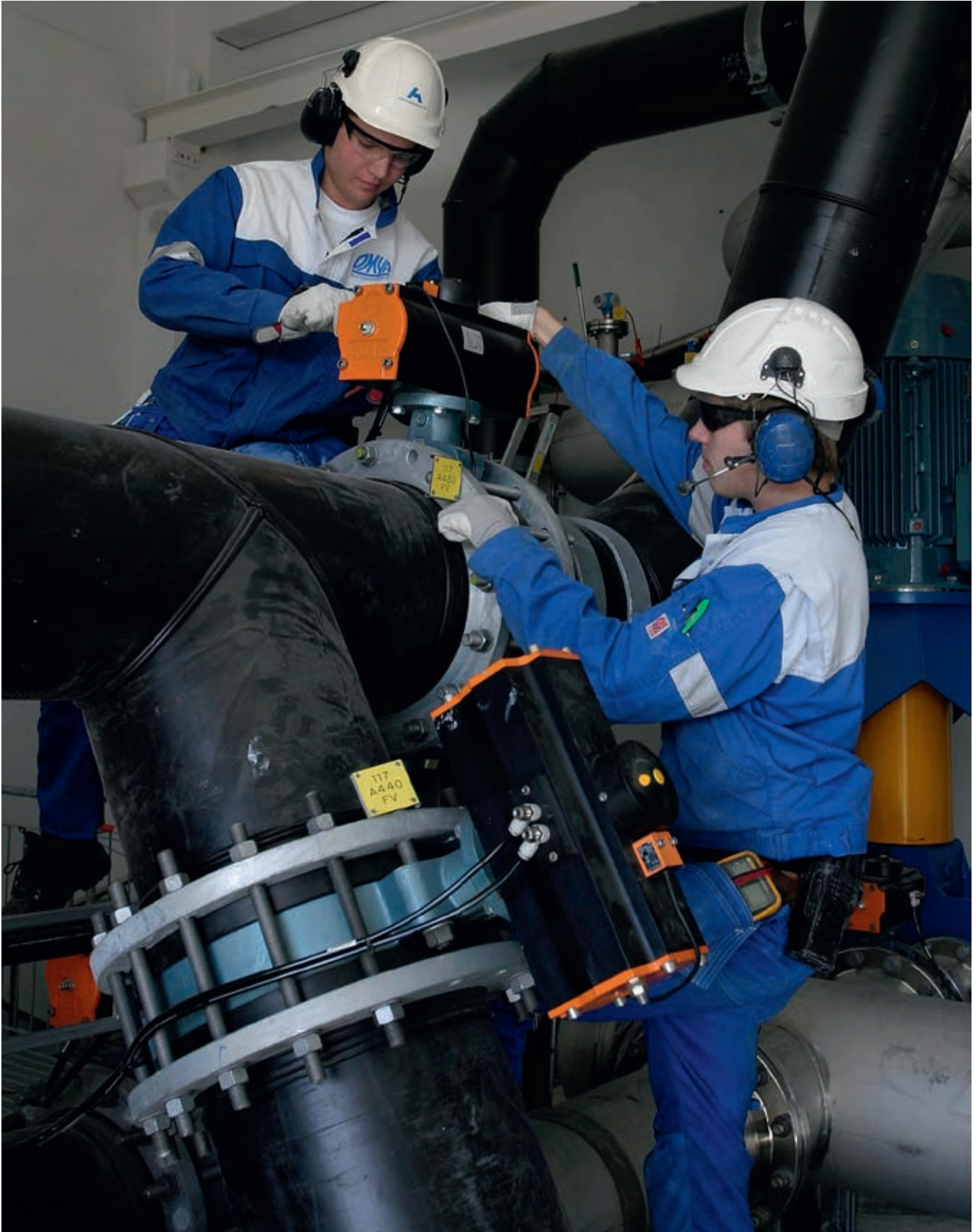
Montering av reguleringsventil for kjølekrets. Arbeidet utføres av lærlinger hos Hustadmarmor AS. Foto: Hustadmarmor A/S
