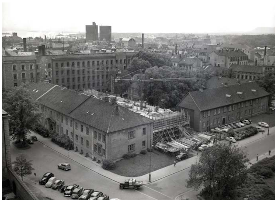
Regjeringskvartalet sett fra nord som viser H-blokken under oppføring på 50-tallet. Foto: Arbeiderbevegelsens arkiv og bibliotek.
