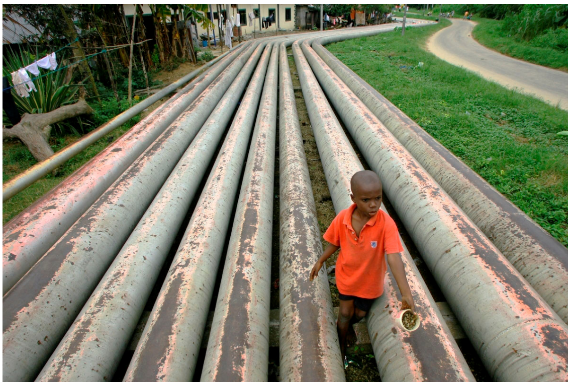
Oljerørledning gjennom en landsby i Nigeria
